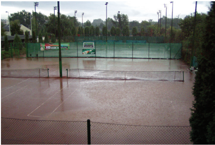
Ha sok eső esik, vízben áll a pálya, pedig alácsövezték egykoron
