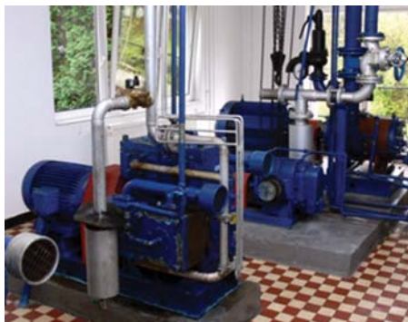
Kompresszorház az 1973-ban beépített gépekkel
