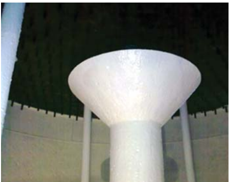
Felújított szűrőtartály belsősész
