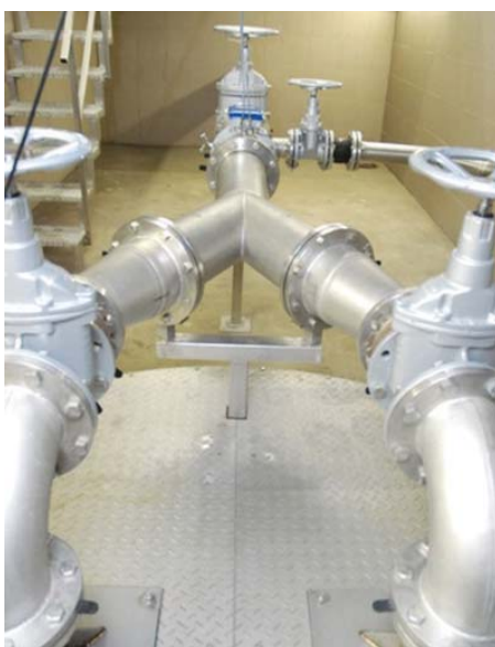
Felújított Csápos II. kút rozsdamentes gépészeti szerelvényekkel
