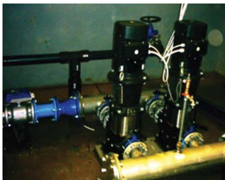
2009-ben felújított ivóvíz átme-lő rozsdamentes gépészete és szivattyúi Becsehelyen
